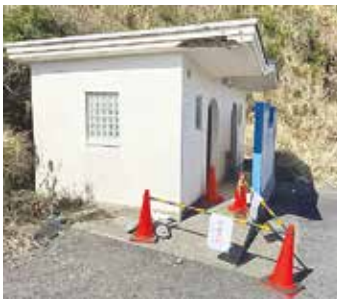
破損した釜の尻公衆便所
