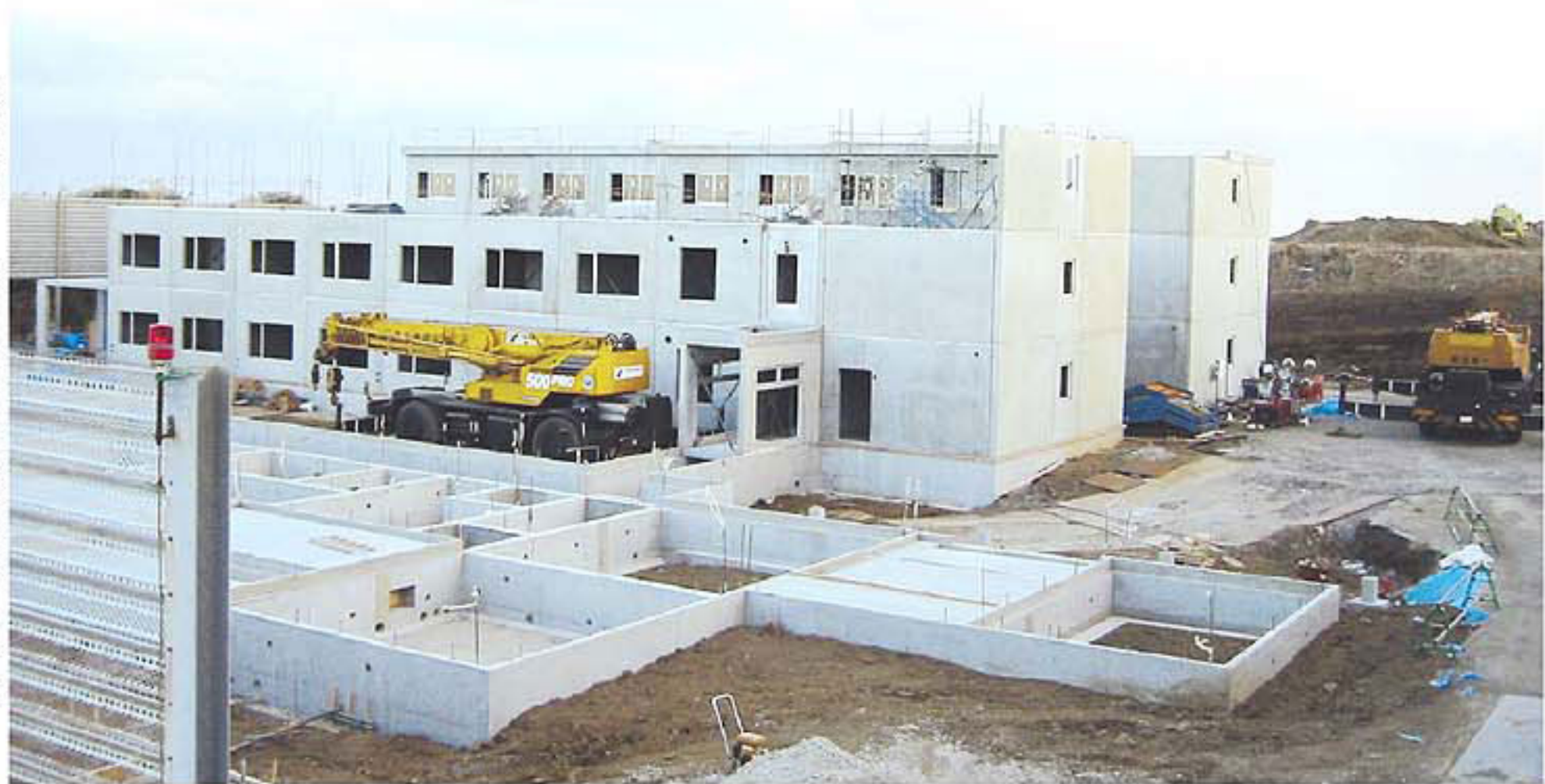
【写真は1月15日現在の三宅島活動火山対策避難施設の工事現場の様子】
