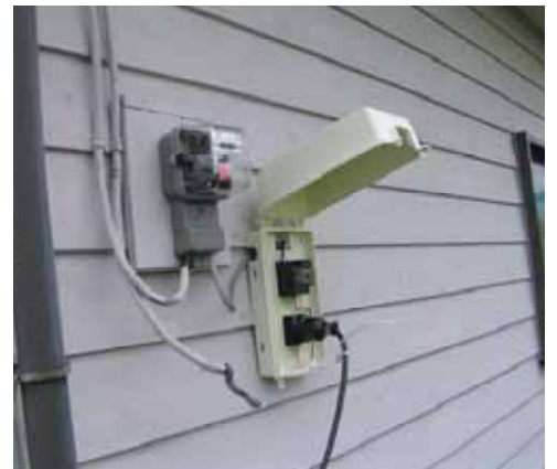
帰宅時に準備された仮設電源
