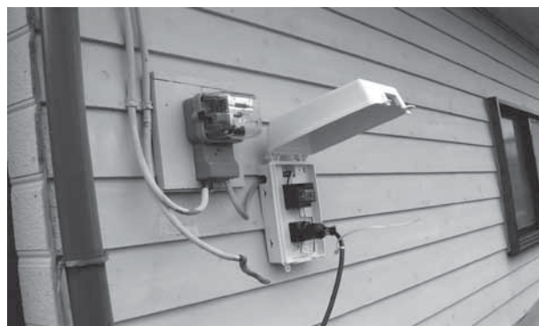
写真 設置された屋外仮設電源
