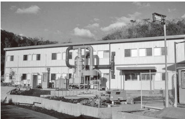
写真 クリーンハウスの脱硫装置
