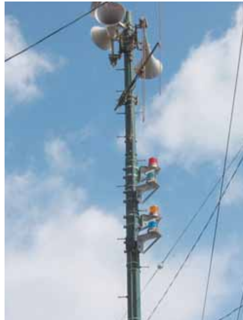
防災行政無線の 回転灯付屋外子局
